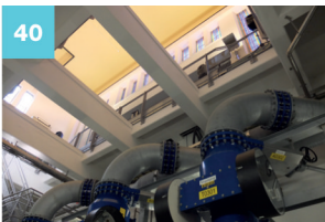
40 Rioolgemaal Damsterdiep Damsterdiep 146 Groningen
